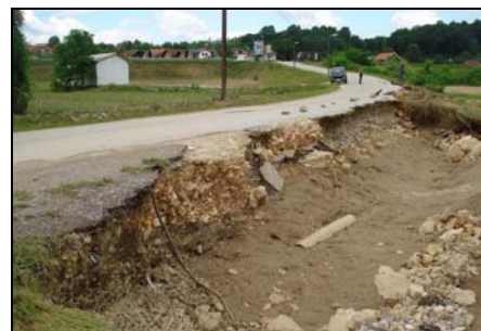
Oštećen je i put za G. Hrgove
