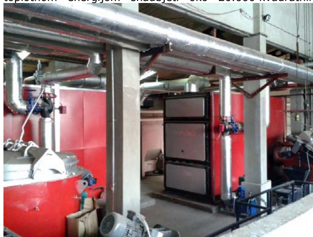
Detalj iz unutrašnjosti novog kotlovskog postrojenja
